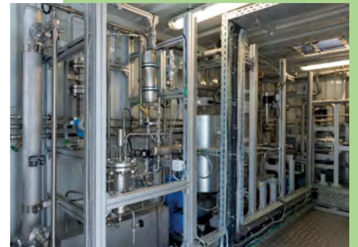
Die Tests der LOHC-Anlage am AREVA-Standort Erlangen sind abgeschlossen.
